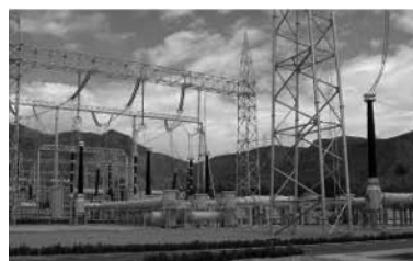
图 1 运行在中国官亭变电站的 800 kV GIS
